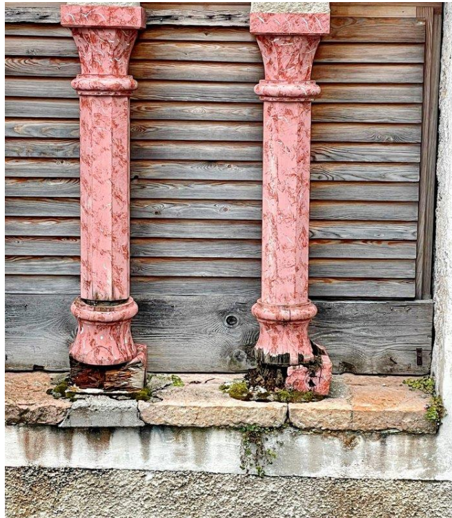
Abbildung 274: Fassade auf Höhe Glockenstube Wetterschäden beim Mauerwerk und an den Fenstersäulen. © Bild: Katholische Pfarre
